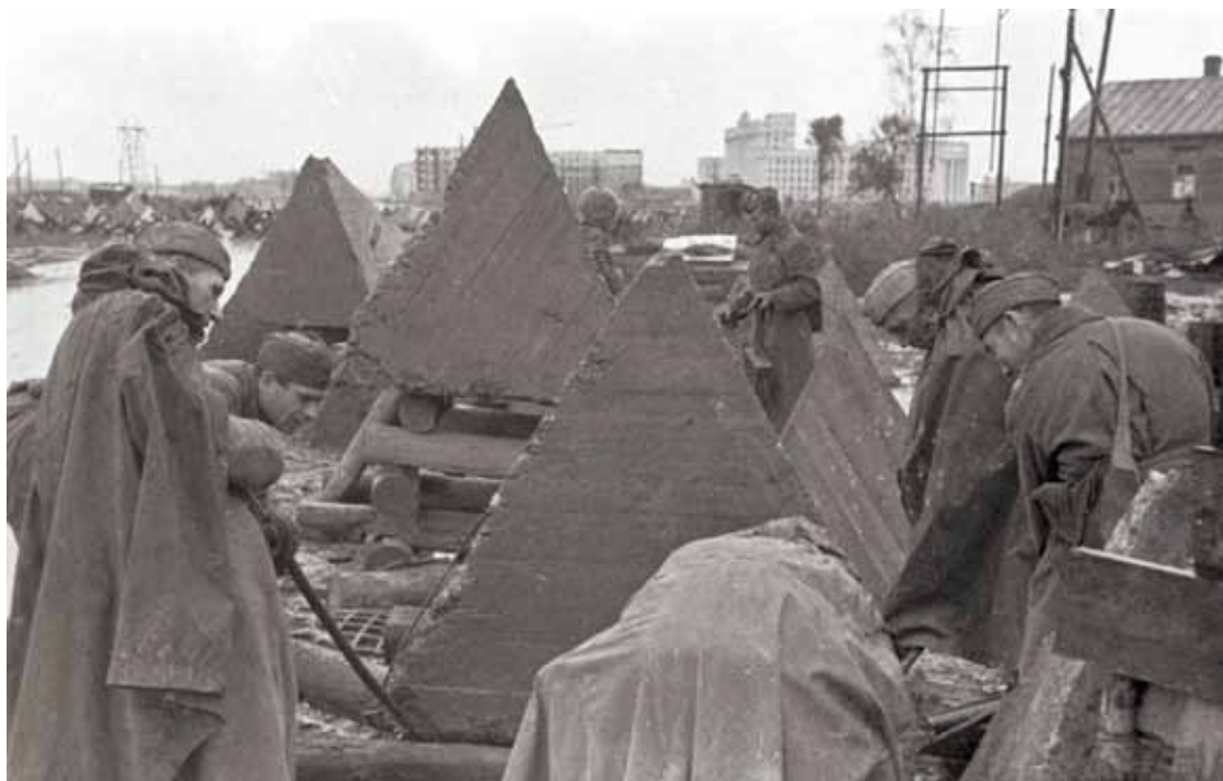
Установка противотанковых железобетонных препятствий на Московском шоссе у Средней Рогатки. Ленинград, октябрь 1941 г. Фотограф В.Г. Федосеев. Из фондов ЦГАКФД СПб.
